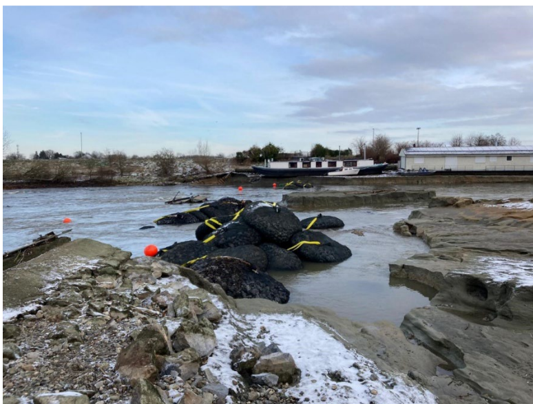
Figuur 3 Nooddam van Rock Bags bij doorgebroken overlaat
